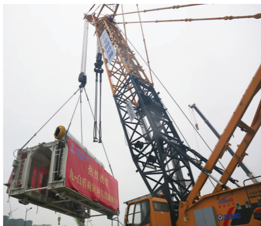
10月10日,成都地铁17号线一期工程首台盾构机在九江北站至白佛桥站区间始发处完成下井组装,标志17号线首个盾构区间开始施工。九白区间由五公司承建。(易晨)
