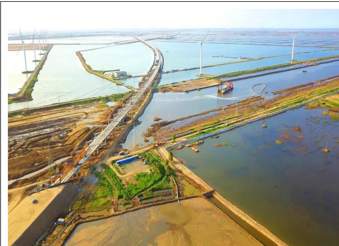
近日，桥隧公司承建的秦滨国家高速公路埋口（鲁冀界）至沾化公路1标鲁北化工特大桥梁左幅贯通。1标段全长为9.628公里，全线以桥梁施工为主，控制性工程鲁北化工特大桥梁全长4379米。截止目前，鲁北化工特大桥梁下部结构全部完成，桥面系完成50%。项目建成后，将实现鲁冀两省高速公路网的衔接，构建两省便捷运输通道。
